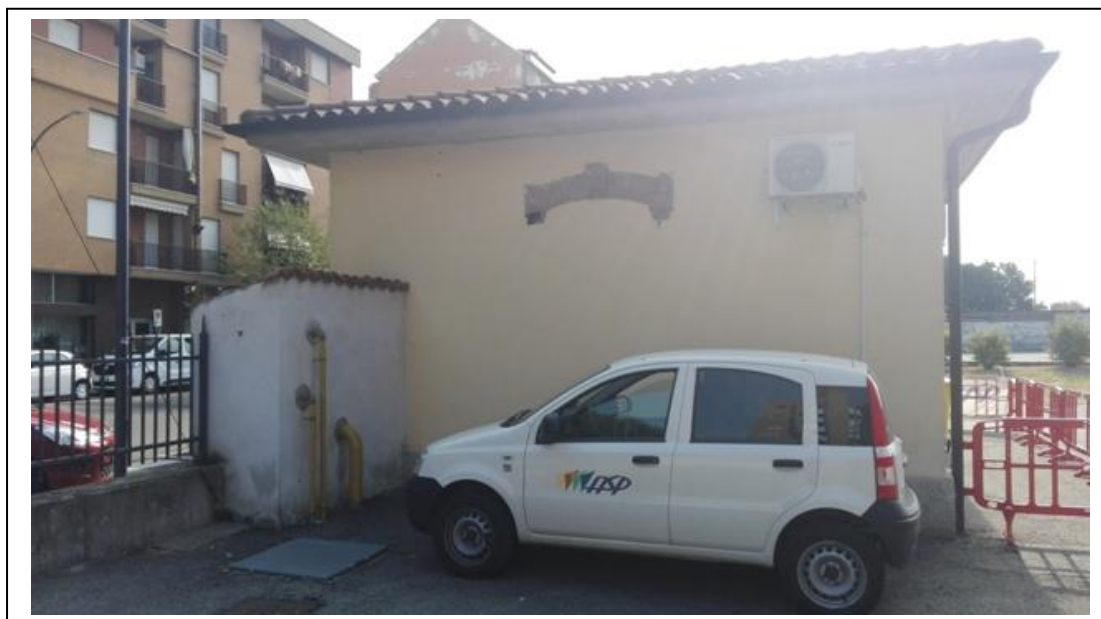
FOTO N°2 – area ovest – palazzina ingresso ASP Servizi – allacci acquedotto e telefonia
