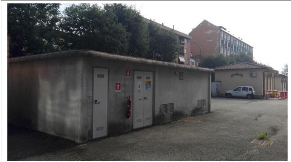
FOTO N°1 – area ovest – cabina di trasformazione MT-BT – allaccio energia
